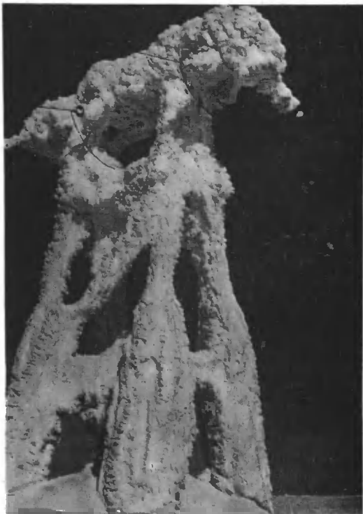
На опорах ЛЭП на плато Расвумчорр нарастает изморозь толщиной более двух метров. Поэтому обычную ЛЭП здесь пришлось заменить кабельным каналом.
